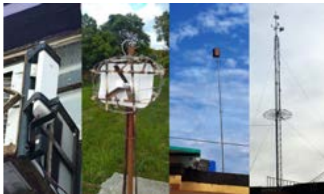
Rys. 6: Obudowy chroniące anteny Wi-Fi przed kradzieżą i zjawiskami atmosferycznymi
